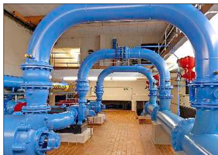
Große Rohrleitungen im Wasserwerk. Foto: Helmut Gall
